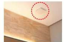
▲循環ファンは場所をとらない天井設置。天井面の意匠ともよく合っている
