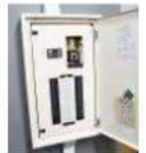
▲サーバールームにある分電盤内に主電源を配置
