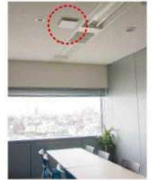
▲会議室にも循環ファンを設置。リモコンで各自が操作し、会議室使用時は強運転に
