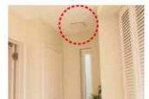
▲玄関ホールの天井に設置
