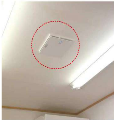
20m 2 ほどの待合室に循環ファン1台を設置▶
