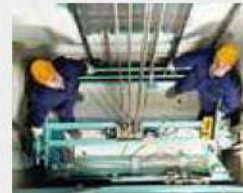
エレベータの出張点検に
