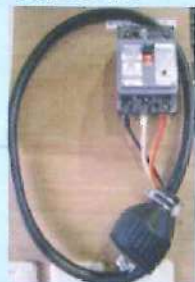
《発電機接続プラグ》
